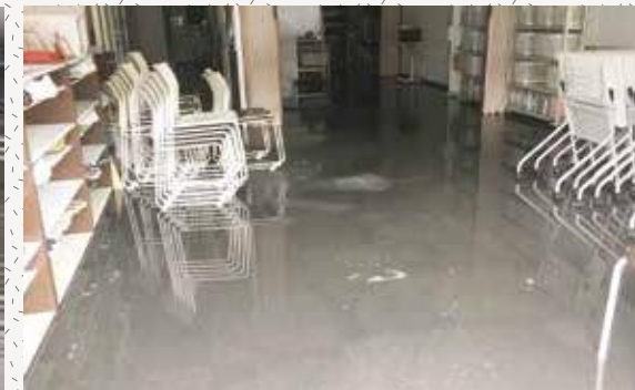
被災した教室
